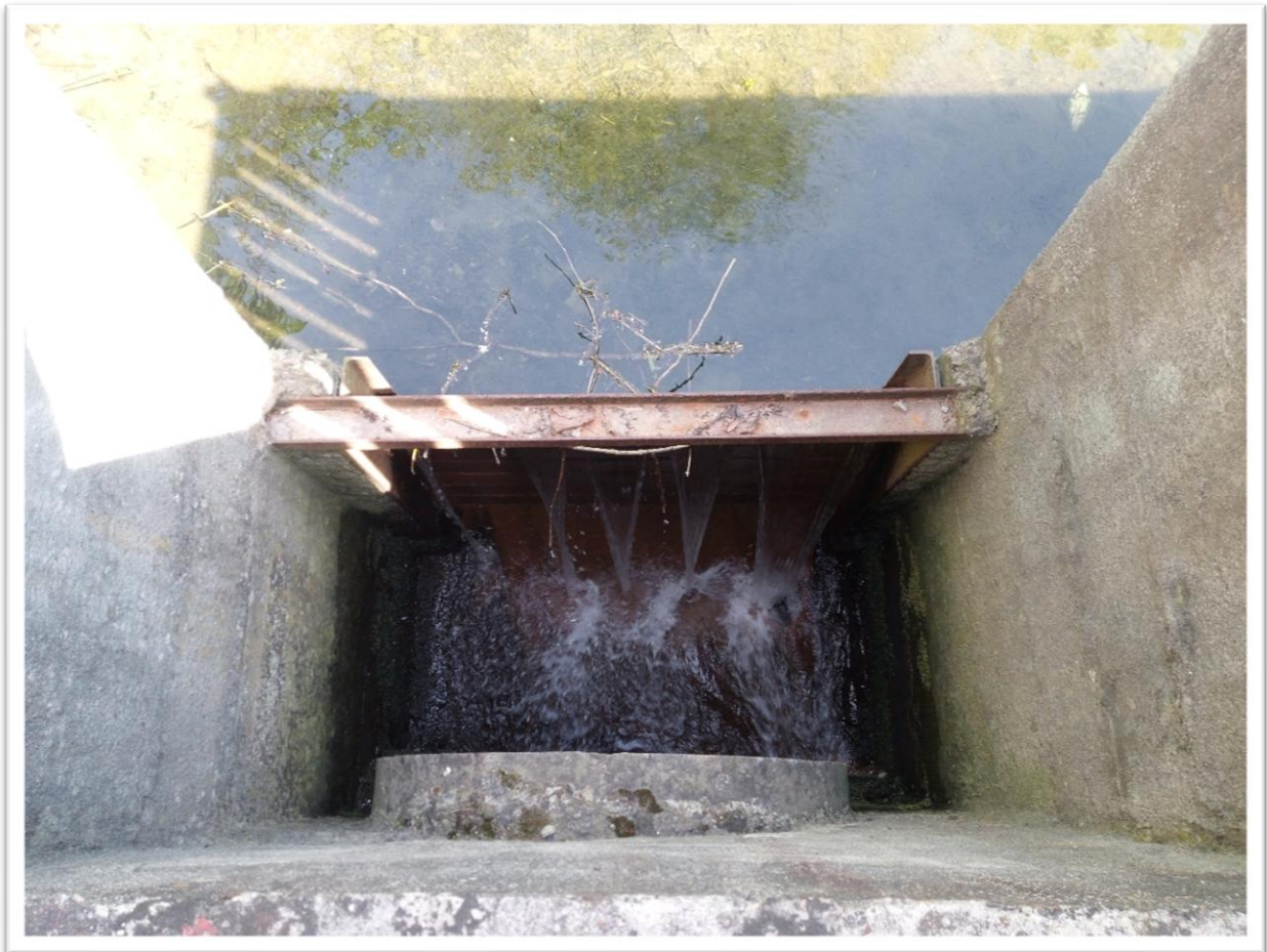
Bilde 1. Nåledam i Haslerbekken som går over i rør under vei.
