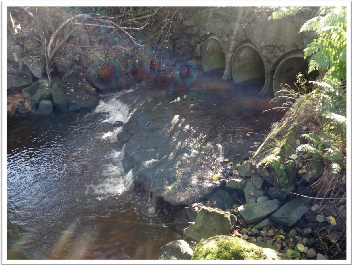
Bilde 1. Tre rør under Bredholtveien er et hinder ved lav vannføring.
