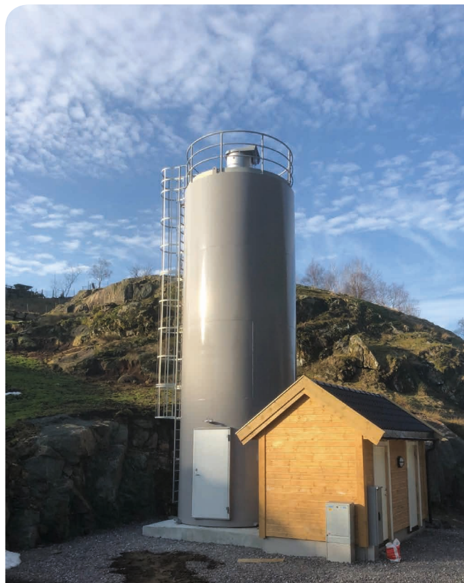
Kalkingsanlegget Løtoft i Soknedal kommune, som har samme løsning med pumping av kalk oppstrøms som Lyse. Foto: Terje Lysnes, Franzefoss Minerals A/S.
