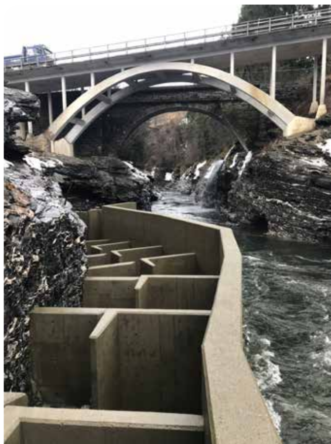
Spaltetrappen under bygging med juvet i bakgrunnen. Foto: Ulrich Pulg, NORCE LFI.
