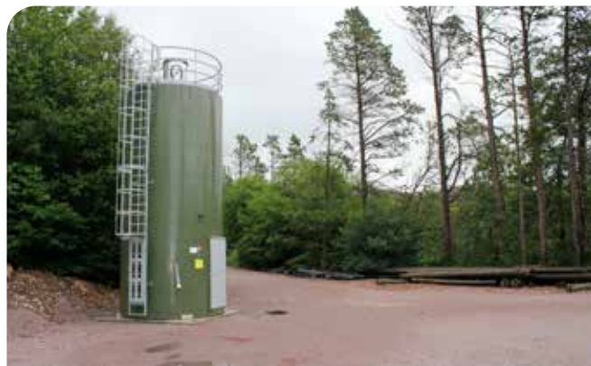
Den nye kalkdoserereren ved Ognaelva. Dette er et moderne anlegg med pH-måling av inntaksvannet fra kraftverket, i hovedelva før kalking samt en pH stasjon nedstrøms anlegget for å sikre god pH i hovedelva.
