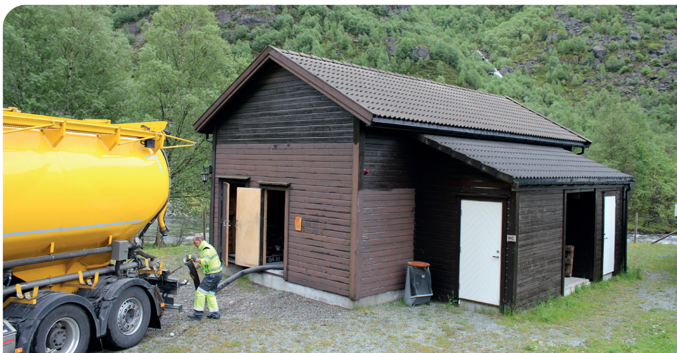
Etterfylling av kalk ved kalkdosereren i Lyse.
