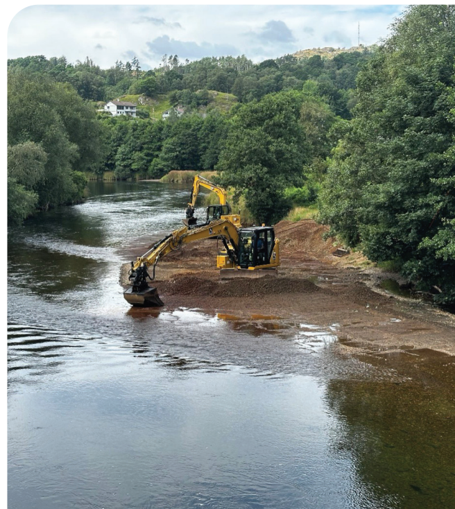
Fjerning av sandbanke ved Øyno i Sokndalsvassdraget som del av miljøtiltak i vassdraget. Foto: Trine Salvesen Røyneberg, Prosjektleder Dalane vannområde.
