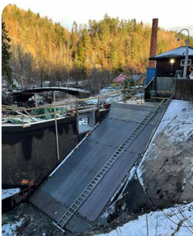
Ombygd inntak ved Fosstveit kraftverk med skråstilt rist, liten lysåpning og en overflatebasert utvandningsrute nær risten. Foto: Tormod Haraldstad.
