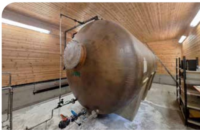
Silikattanken ved Storåsfoss innvendig. Herfra blandes silikat inn og avsyrer vannet fra Storåsfoss og nedstrøms.
