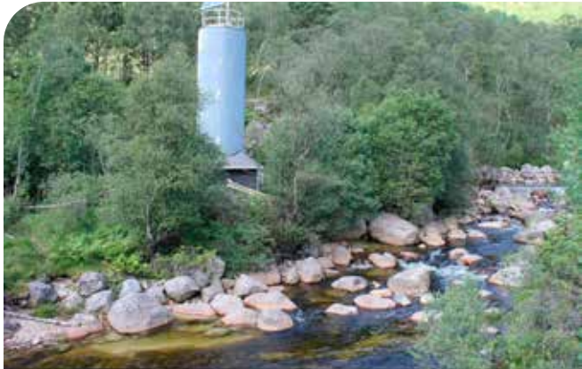
Kalkdosereren i sideelva Vindøla, i øvre del av Espedalselva. Dette er den ene av to kalkdoserere i dette vassdraget.
