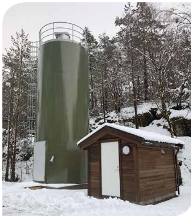
Den nye kalkdoseren ved utløpet av Lundevatnet. Foto: Birgit Solberg, Fylkesmannen i Aust- og Vest-Agder.
