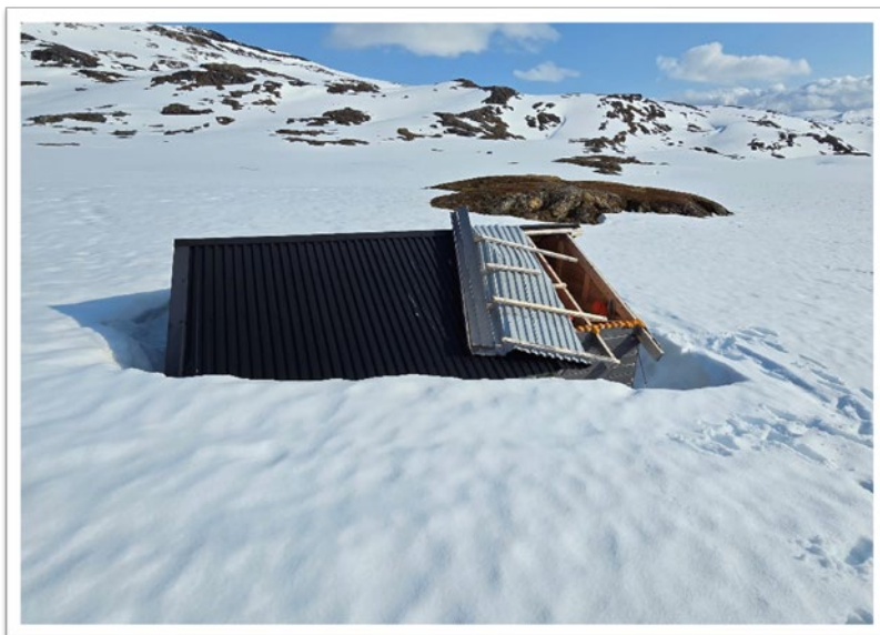
Stormskader på nausttak (Foto; Jon Meisfjord)
