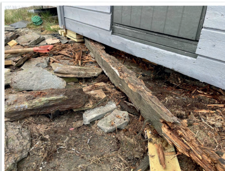
Råtten bæring (Foto Jon Meisfjord)
